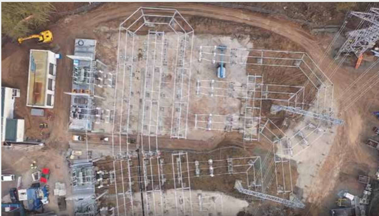
Fast fertiggestelltes Umspannwerk Mainspitze
