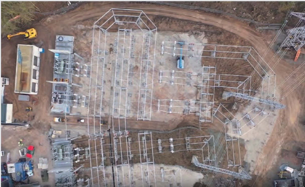
Fast fertiggestelltes Umspannwerk Mainspitze
